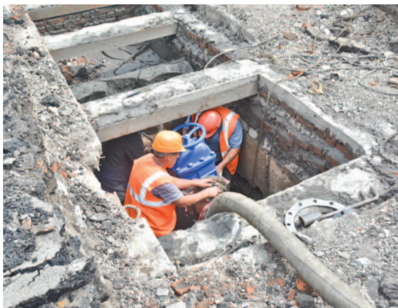
За короткое сибирское лето нужно отремонтировать и подготовить к зиме как можно больше сетей и сооружений.
